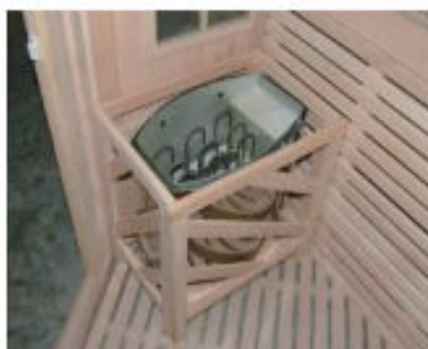
Emplacement du poêle
